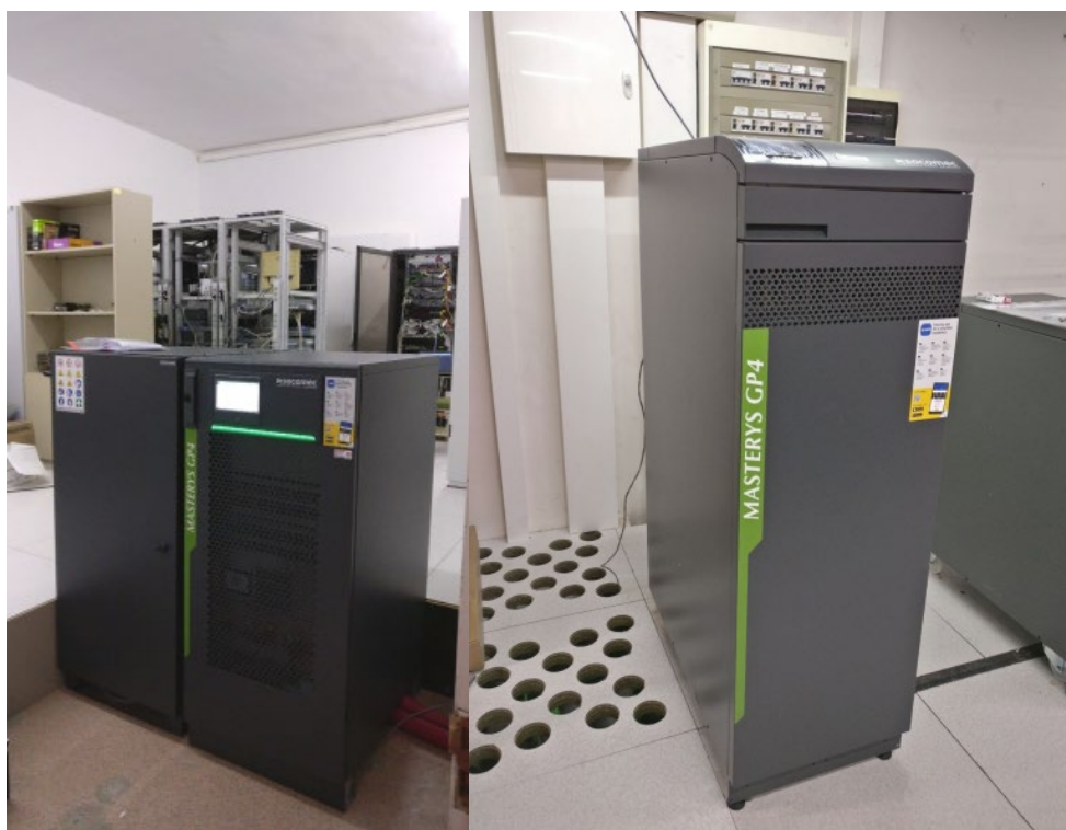
Nous sistemes d'alimentació ininterrompuda dels CPDs dels edificis D5 i D4.
